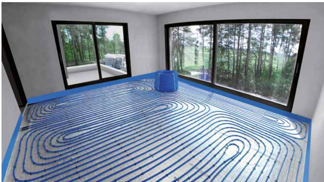
Slika 3. Instalacija podnog grejanja u jednoj porodičnoj zgradi, korišćenjem blueFLOOR PERT cevi i KAN-therm Tacker sistema.
