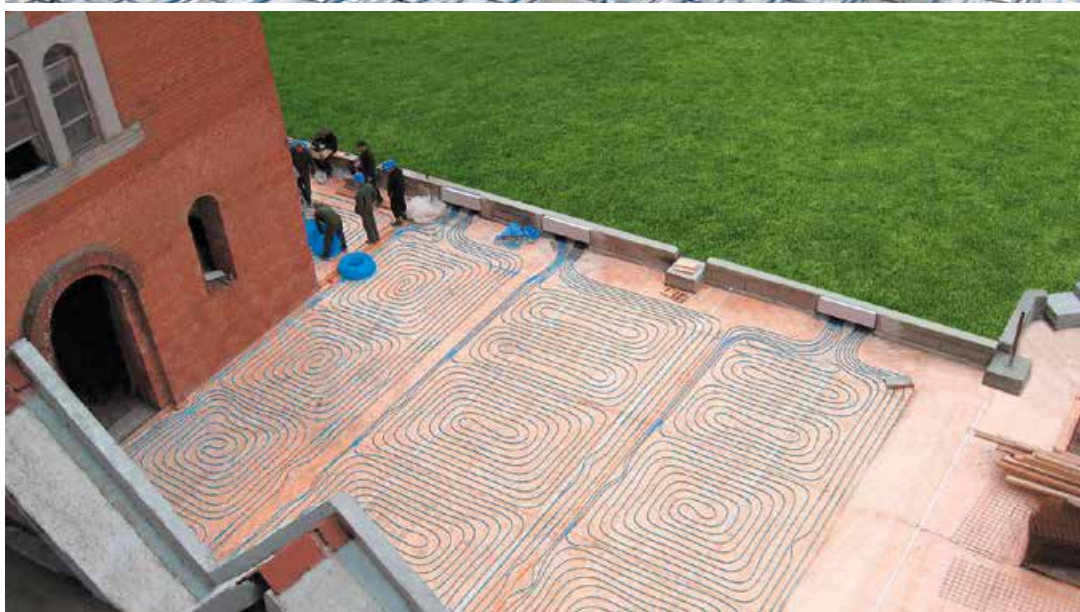
Slika 5. Instalacija grejanja spoljnog pacija korišćenjem blueFLOOR PERT cevi KAN-therm sistema.
