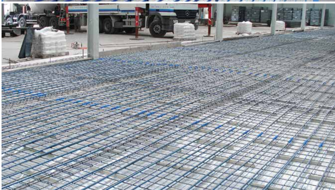
Slika 4. Instalacija podnog grejanja u industrijskom objektu, korišćenjem blueFLOOR PERT cevi i KAN-therm NET sistema.
